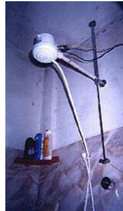
Residência - Equipamento empresa SOLETROL
