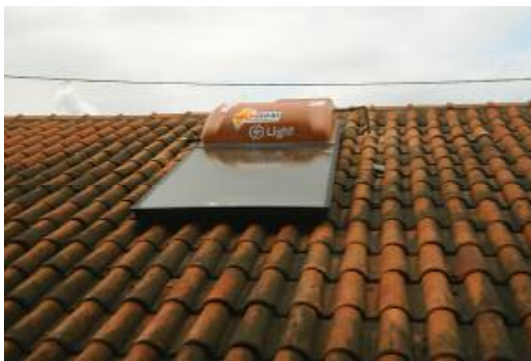
Equipamento Solarfort da empresa UNIPAC
