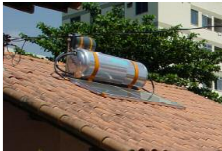
Equipamento Solarmax da empresa SOLETROL
